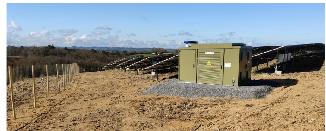
Photographie 1: Exemple d'un poste de conversion
