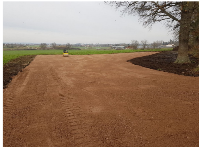
Photographie 5 : Exemple de piste interne d'une centrale photovoltaïque
